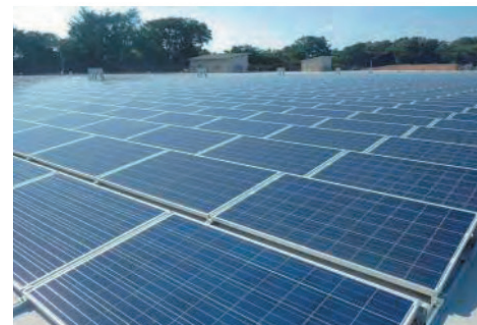
生田配水池上部太陽光
