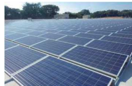
配水池上部の活用事例 (太陽光発電)
