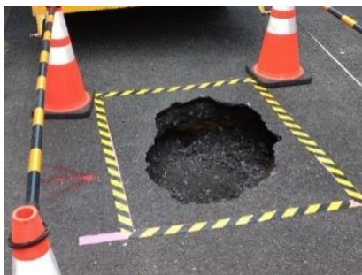
管きよの破損による道路陥没
