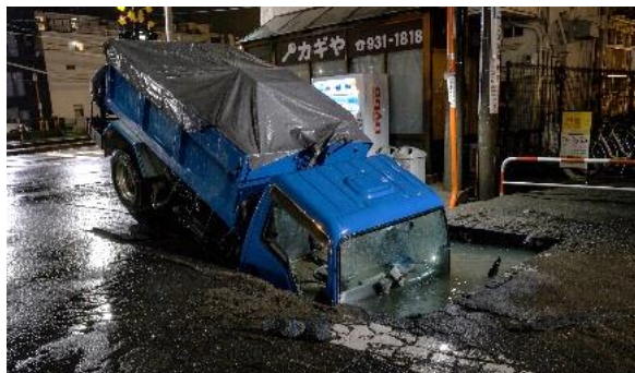
配水管漏水による道路での陥没(令和4年4月・多摩区)
