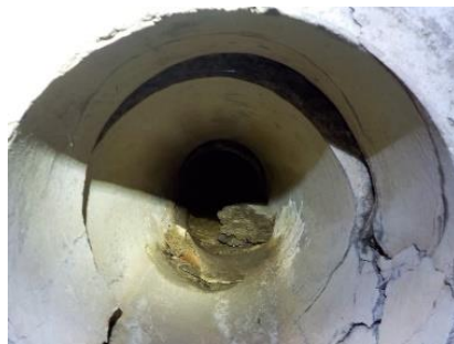
管きよ内部の破損状況
