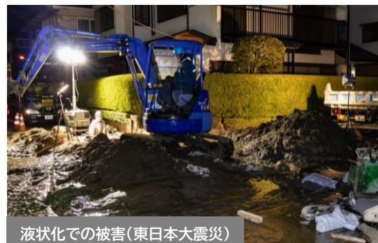
液状化での被害(東日本大震災)
