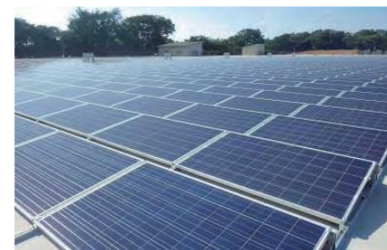
配水池上部の活用事例 (太陽光発電)
