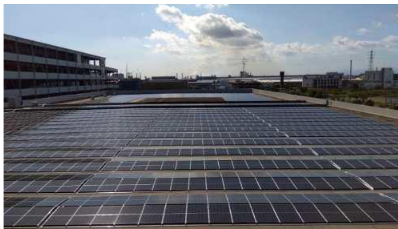
太陽光発電設備の設置状況
