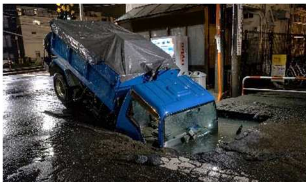
配水管漏水による道路での陥没(令和4年4月・多摩区)
