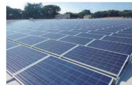
配水池上部の活用事例 (太陽光発電)
