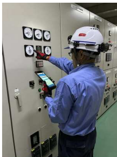
タブレットを活用した設備の点検（設備管理システム）
