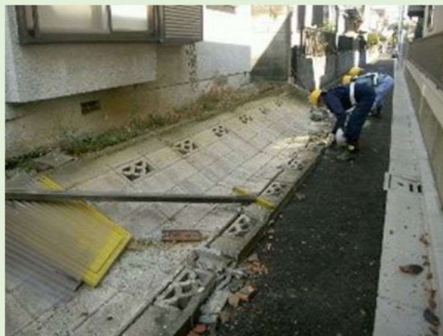
塀等の倒壊で道路が閉塞しやすい
