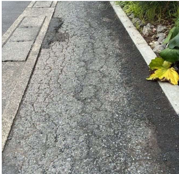
現地の舗装状況（ひび割れ等、損傷しているため、寄附にあたり補修が必要）
