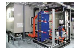
●コージェネレーションシステム
