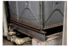
(受水槽の発錆、配管経年劣化)
