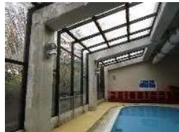
(プール壁面の塗装の剥離)
