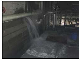
(プール循環配管の破断)
