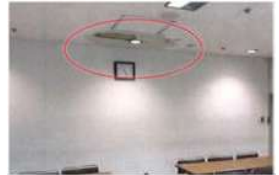
(漏水による会議室天井の欠落)
