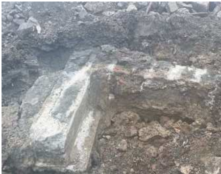
地中障害物の一部（コンクリート塊）
