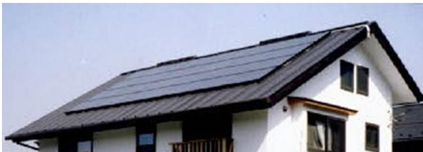
個人住宅の太陽光発電パネル設置例
