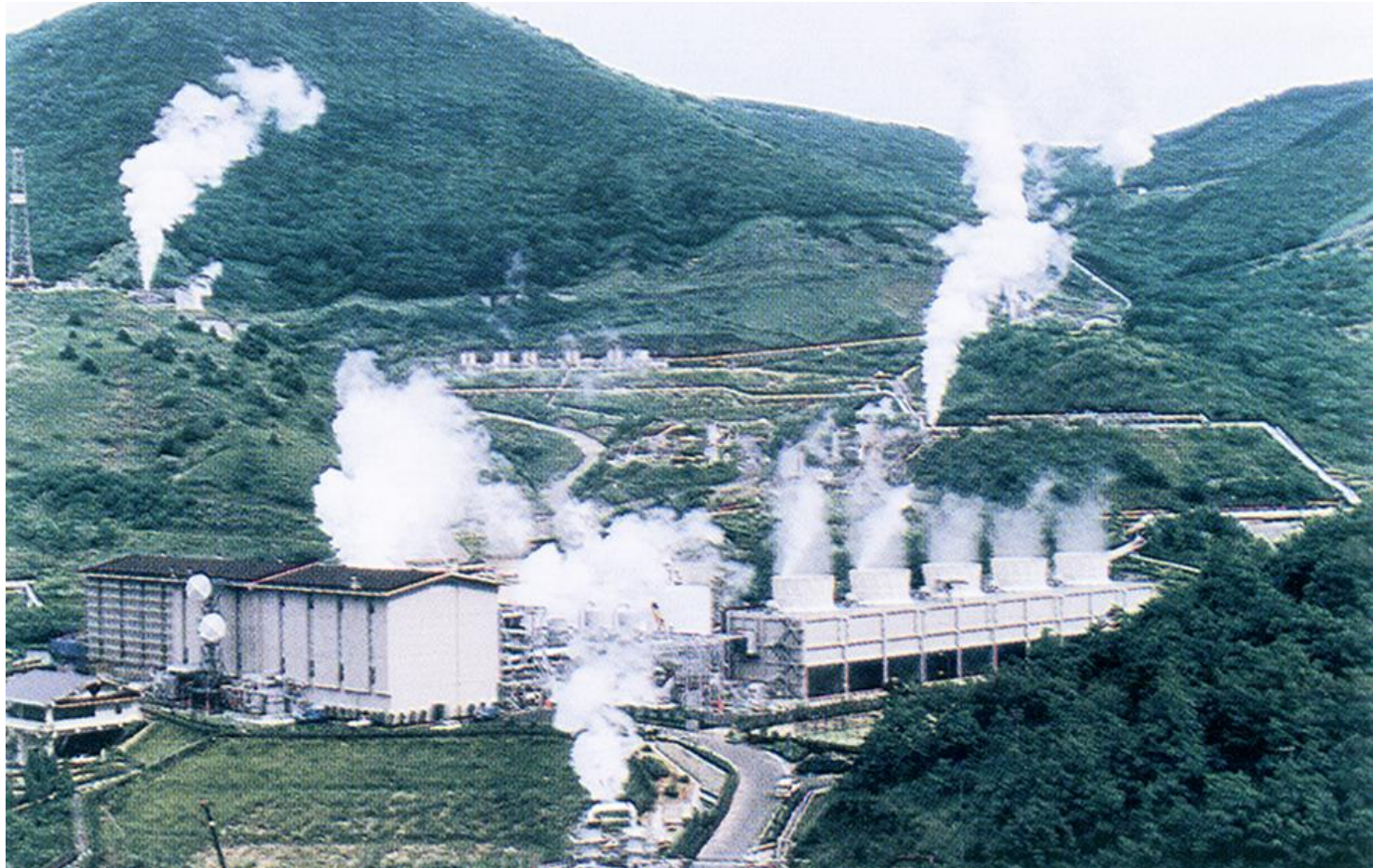
大分県八丁原地熱発電所（1号機と2号機で出力11万kW）
