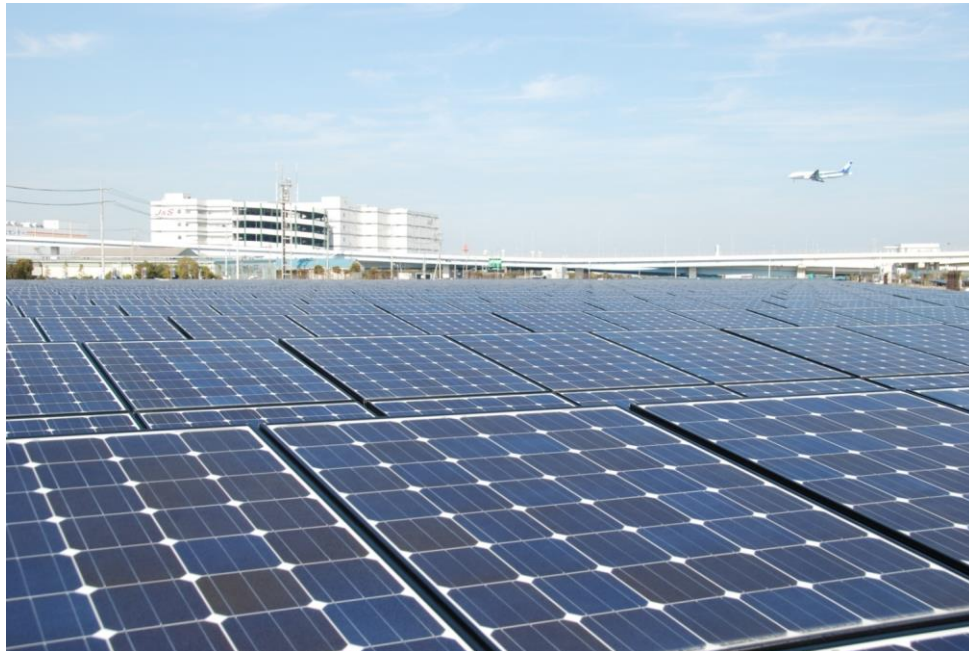
川崎大規模太陽光発電所（浮島発電所）
