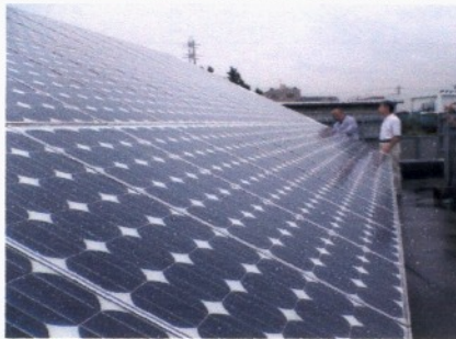
屋上の太陽光発電パネル=3kW
