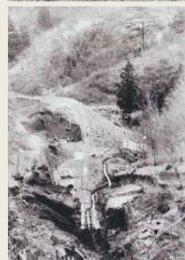
里山フォーラム賞 井上俊夫氏提供 「柿生隧道(トンネル)工事の様子」 全6枚 写真上はトンネル上から上麻生方面を、下は真福寺方面を臨む
