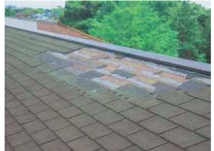
アスファルトシングル劣化
