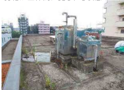
保護コンクリート劣化
