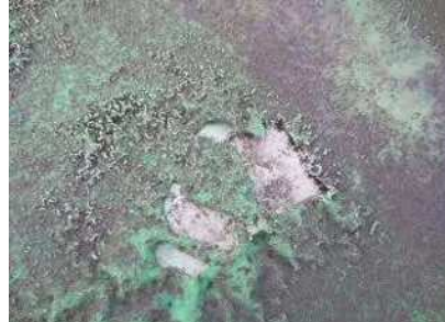
ウレタン塗膜防水破れ
