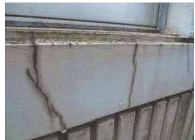
壁面のひびわれ
