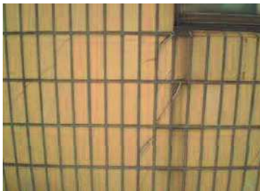
タイル面のひびわれ
