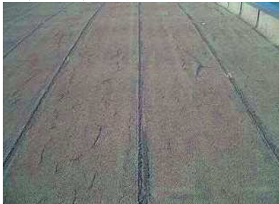
アスファルト防水劣化
