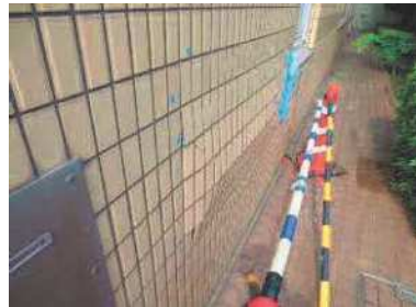
タイルの浮き
