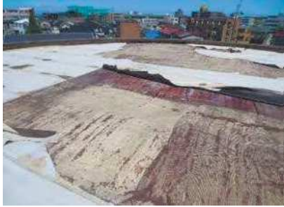
シート防水破れ
