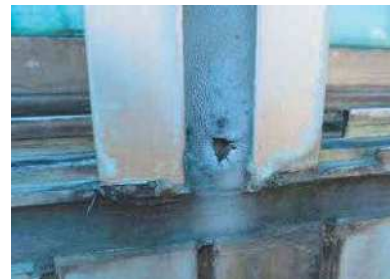
シーリング割れ
