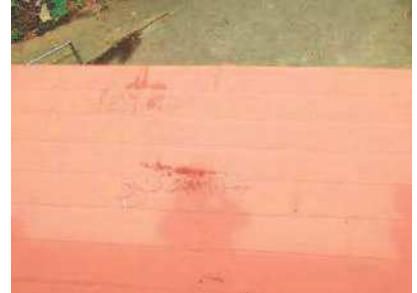
金属板屋根塗装はく離
