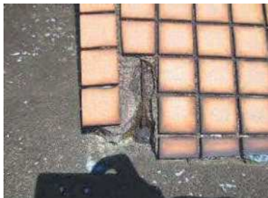
コンクリートを含むはく落(鉄筋露)
