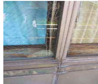
シーリングの変形
