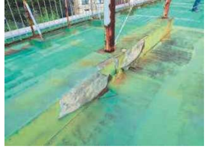
ウレタン塗膜防水破れ
