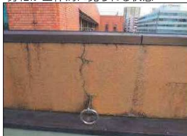
壁面のひびわれ
