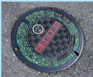
応急給水拠点のマンホール
