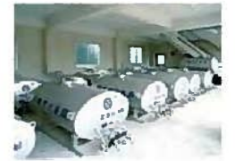
◆給水タンク (1トン81基)
