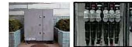
課電ポイント(事故点探査拠点)
