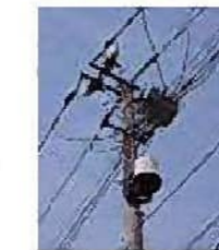
事故区間でない健全区間を他の配電線から遠方操作にて救済
