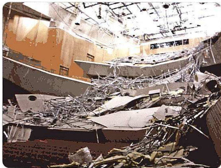
東日本大震災による天井崩落の様子
