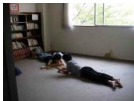
カーペットが汚れている(子母口)
