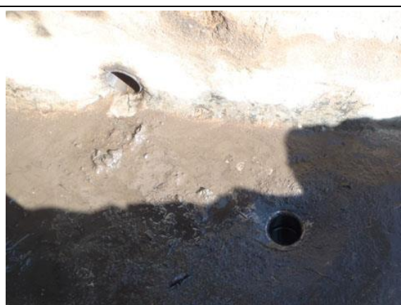
ポンプにつながる排水口
