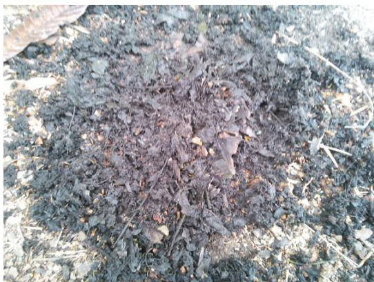
雨樋に詰まっていた落ち葉
