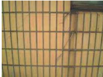
タイル面のひびわれ
