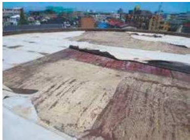
シート防水破れ
