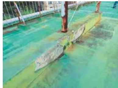
ウレタン塗膜防水破れ
