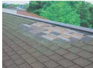
アスファルトシングル劣化
