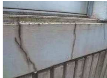
壁面のひびわれ
