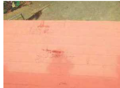
金属板屋根塗装はく離
