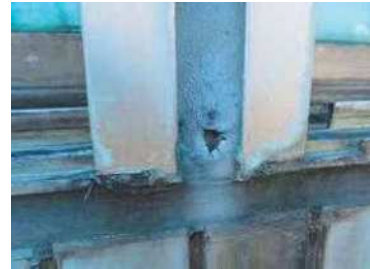
シーリング割れ
