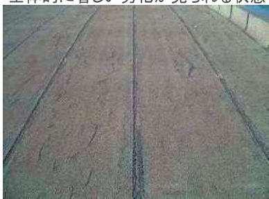
アスファルト防水劣化
