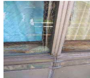
シーリングの変形
