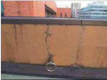
壁面のひびわれ
