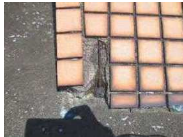
コンクリートを含むはく落(鉄筋露
