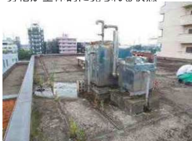
保護コンクリート劣化
