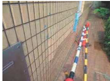
タイルの浮き
