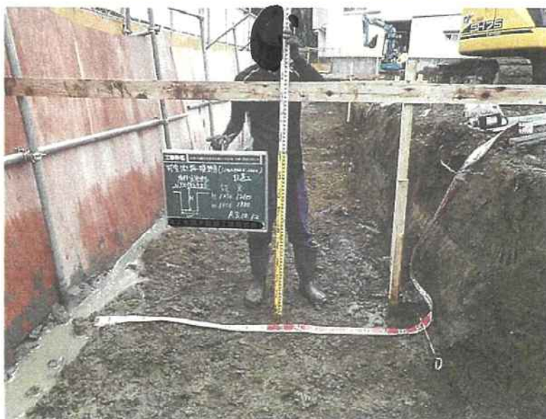
可変側溝横断用設置工 床付出来形FH±0 設計 実測 H 1230 1260 W 1800 1900 令和3年10月12日
