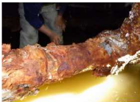
トイレ排水管の腐食の状況
