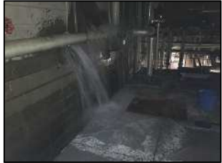
(R4：プール循環配管破損) ※R4.10～R5.5：プール休止
