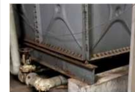
（受水槽の発錆、配管経年劣化）
