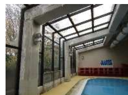
（プール壁面の塗装の剥離）
