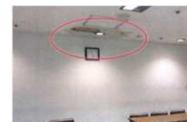
（漏水による会議室天井の欠落）
