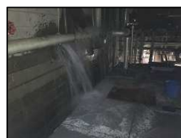
（プール循環配管の破断）
