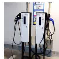
普通充電設備
