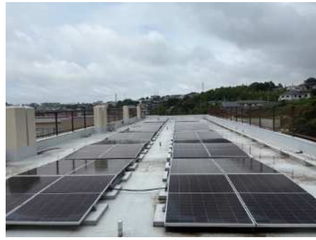
菅生小学校の太陽光発電設備
