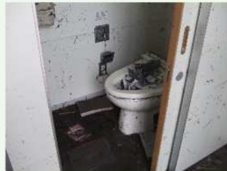
（出典：日本トイレ研究所）
