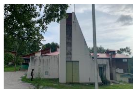
躯体の劣化が著しい エネルギー棟
