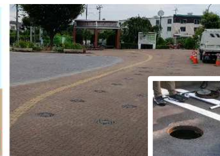
平常時のマンホールトイレ
