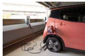
▲マンションへの充電設備の設置例
