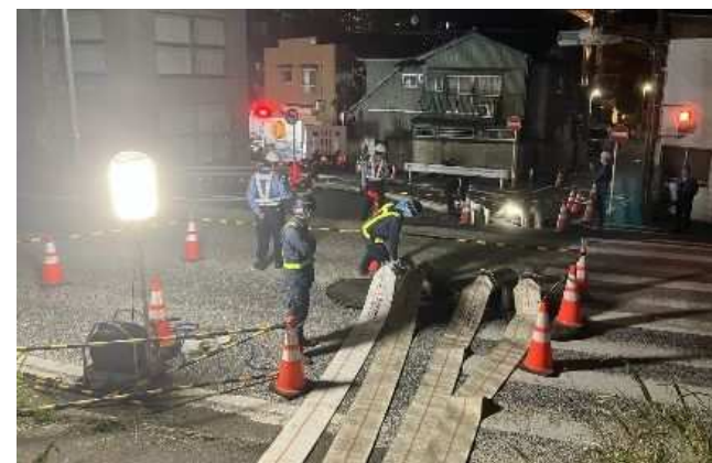
排水樋管浸水対策夜間訓練
