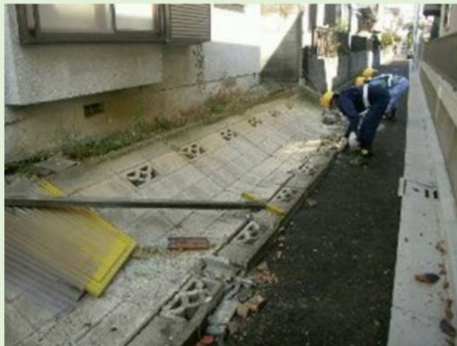
塀等の倒壊で道路が閉塞しやすい
